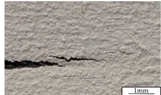
Ramificación de grieta
