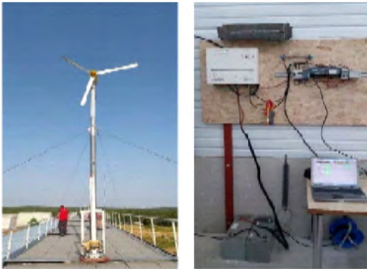
Figura 6: Instalación del aerogenerador y tablero de medición (Imágenes cedidas por CIEMAT)
